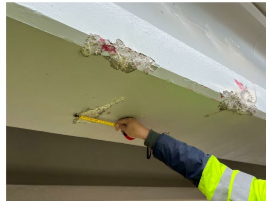
Рис. 2.8. Измерение параметров повреждений балки
